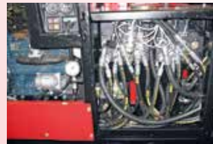
Die Schaltung für die hydraulische Steuerung wurde von Müller-Fahrzeugtechnik selbst entwickelt
